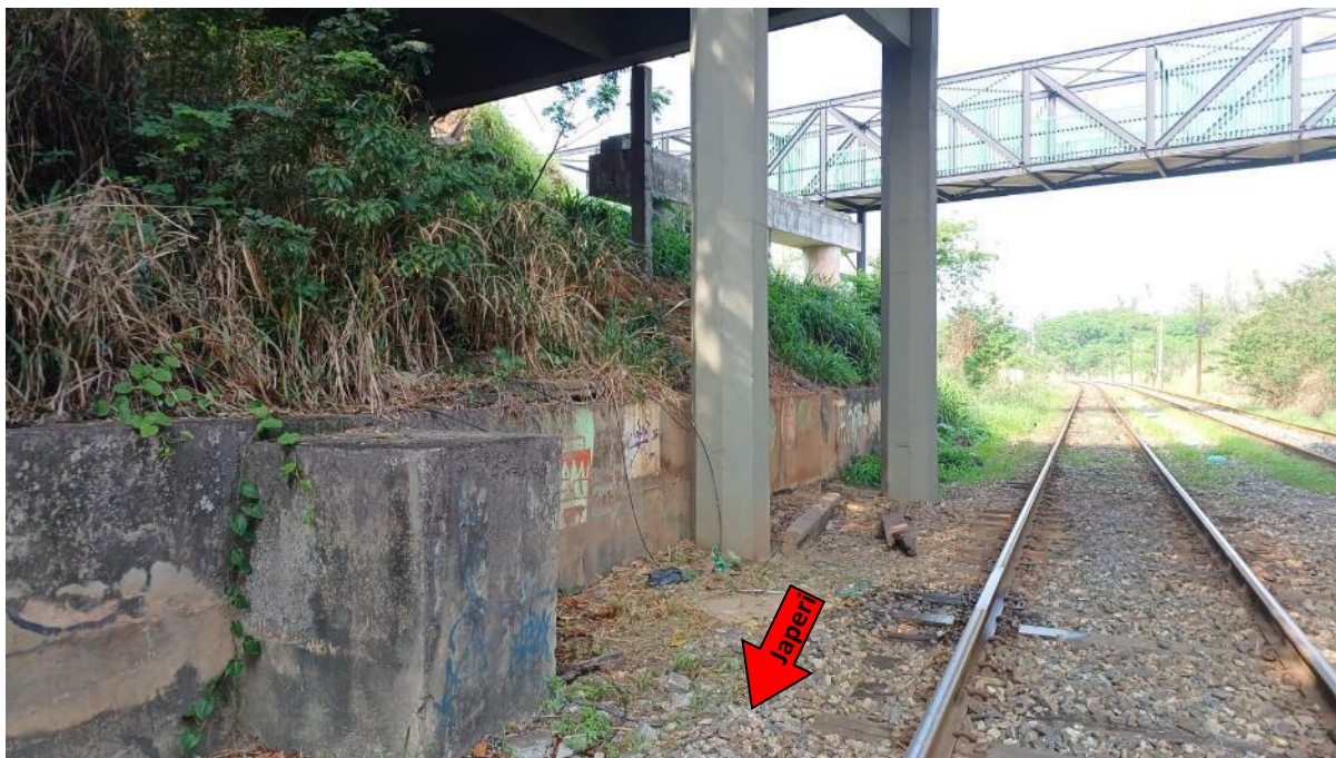
Figura 12. Vista em detalhe dos alicerces e estruturas de contenção de encosta do viaduto da BR-465 (próximos à linha férrea).
