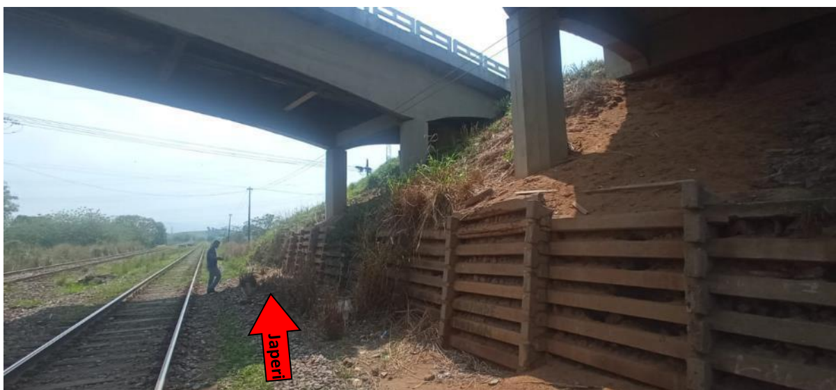
Figura 29. Vista em detalhe da margem esquerda (sentido Japeri) das estruturas de sustentação e contenção sob o viaduto da BR116 – Rodovia Presidente Dutra.
