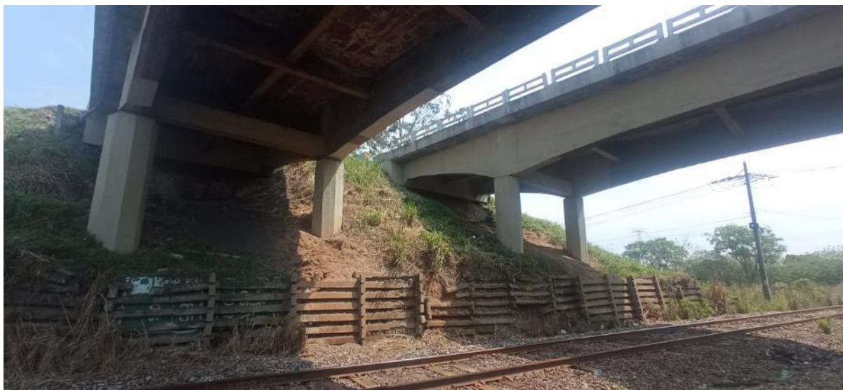
Figura 28. Vista em detalhe das estruturas de sustentação e contenção sob o viaduto da BR116 – Rodovia Presidente Dutra.
