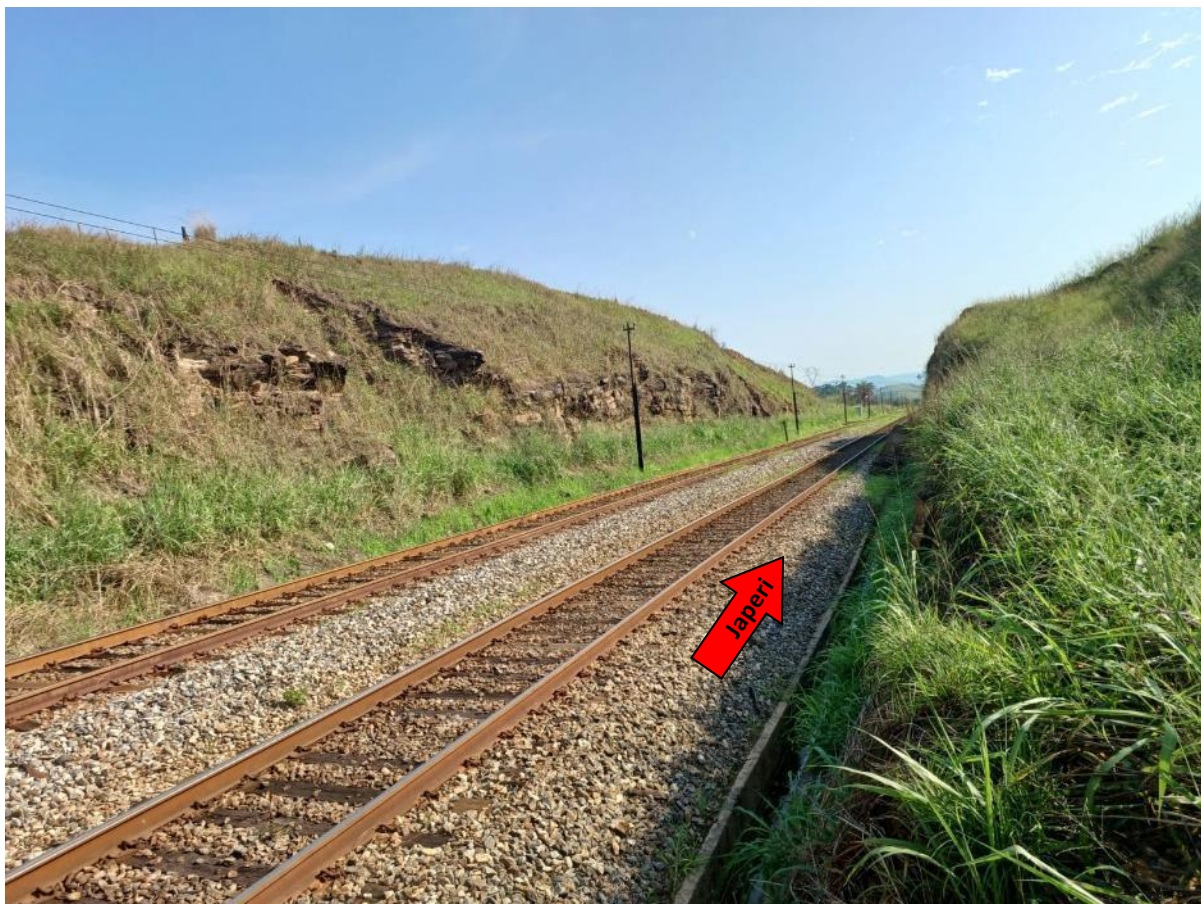
Figura 34. Vista a partir dos trilhos no “Ponto 53/MRS”: existência de dois morros com aproximadamente 100 metros de extensão e 8 metros de altura cada. Ambos morros foram recortados para a passagem dos trilhos, sendo necessário “aparar” a margem para a ampliação da faixa marginal.
