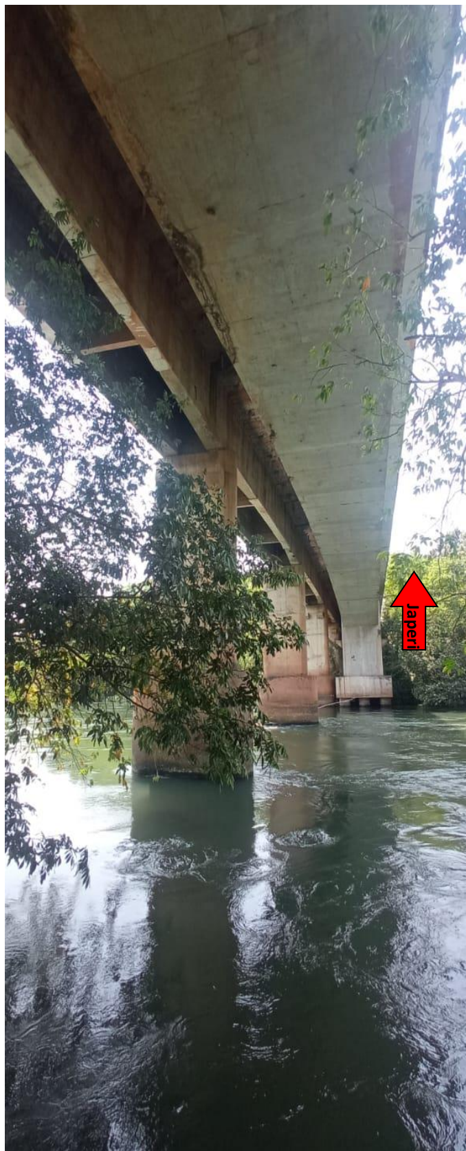
Figuras 48, 49, 50, 51 e 52. Viaduto sobre o Rio Guandu, em diversas perspectivas, construído nos limites de área do Exército Brasileiro
