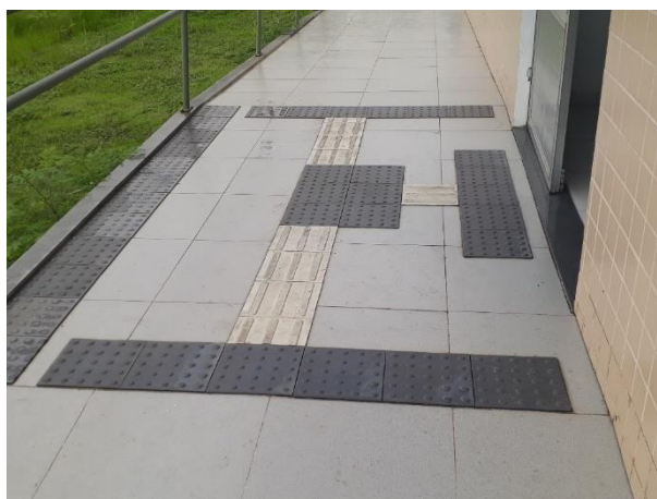
Figura 54: Sinalização tátil no piso - IM
