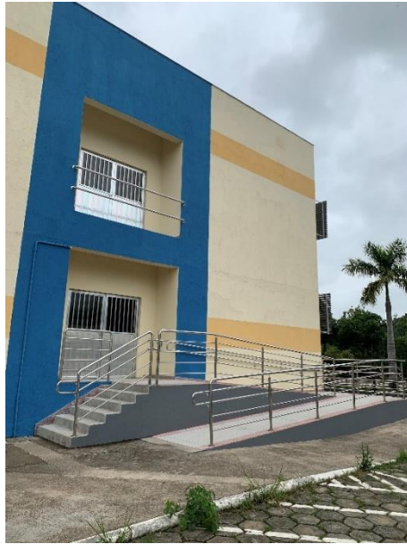
Figura 25: Nova rampa de acesso a setor de atendimento direto ao público (Núcleo de Prática Jurídica) no prédio do ITR, em projeto de reforma recém executado.
