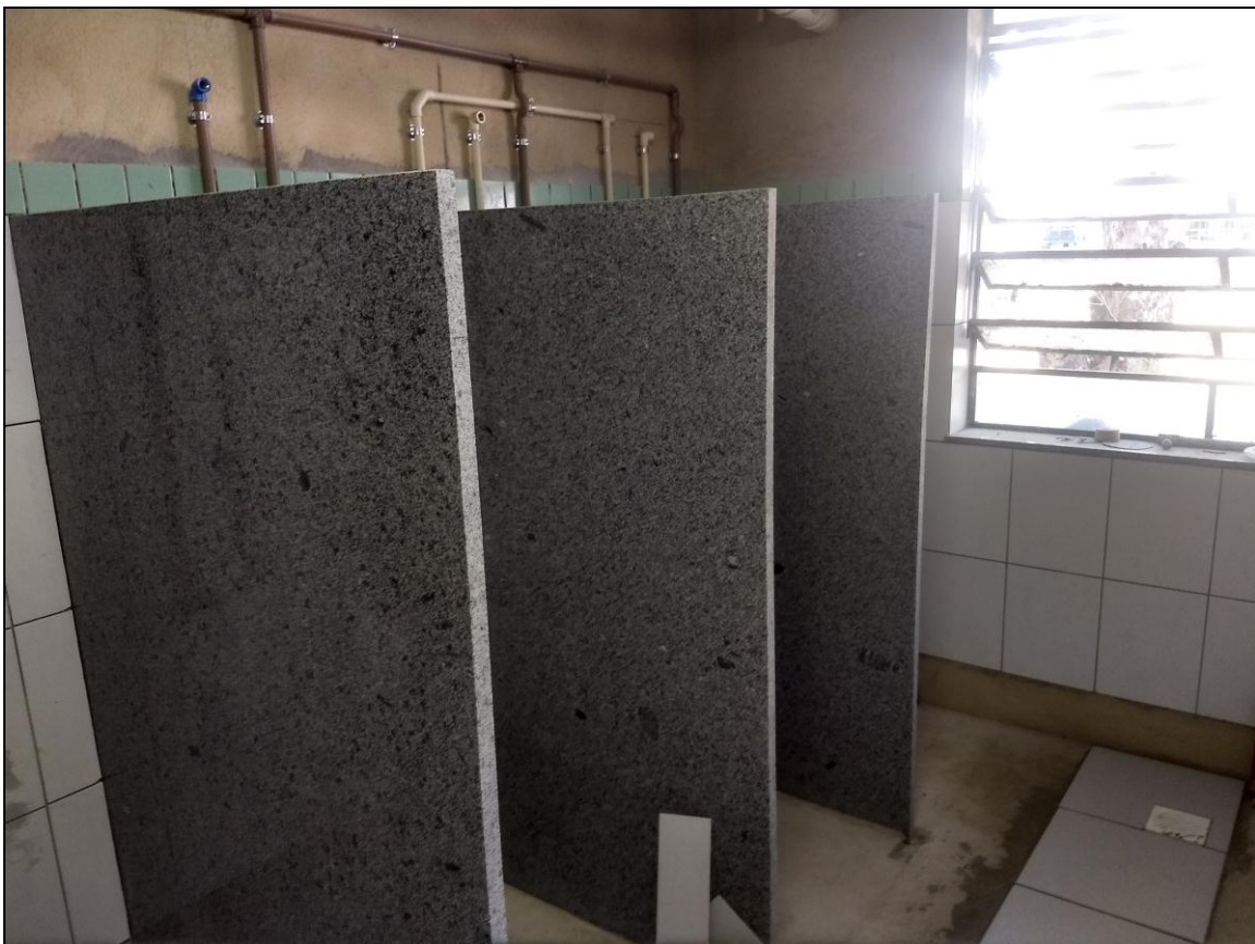
Foto 06 - Início da instalação das paredes divisórias de granito nos banheiros do 1º Andar.
