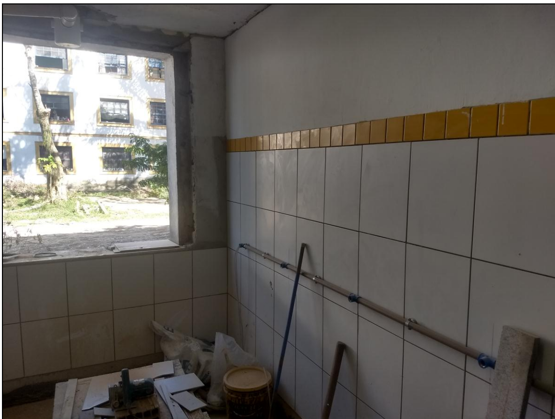
Foto 03 – Início da instalação do revestimento cerâmico das paredes dos banheiros do 1º Andar.
