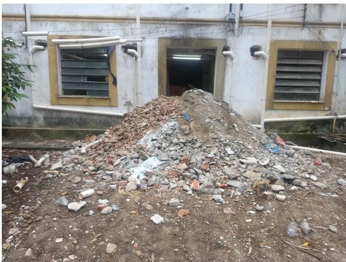
Foto 16 - Execução de serviços de demolição da infraestrutura antiga do banheiro do 1º Andar
