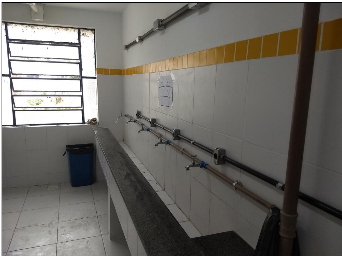
Foto 08 – Tanques para higiene pessoal instalados nos banheiros concluídos do 2º e 3º Andar
