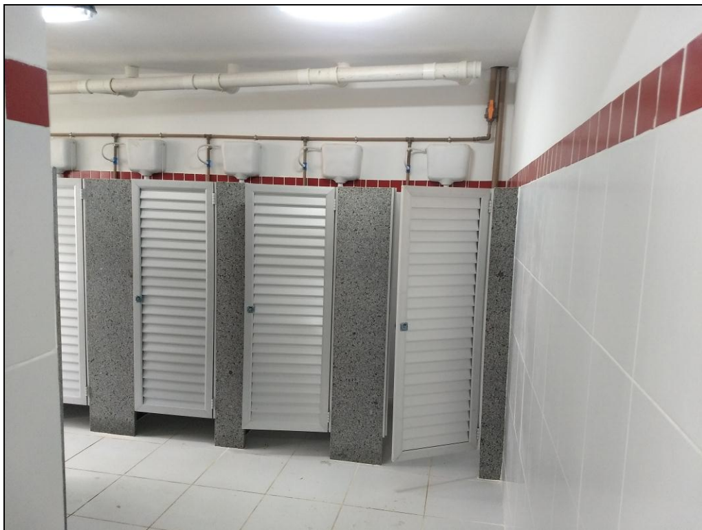
Foto 01 – Vista da área dos sanitários com divisórias e portas de alumínio dos banheiros do 2º e 3º andar
