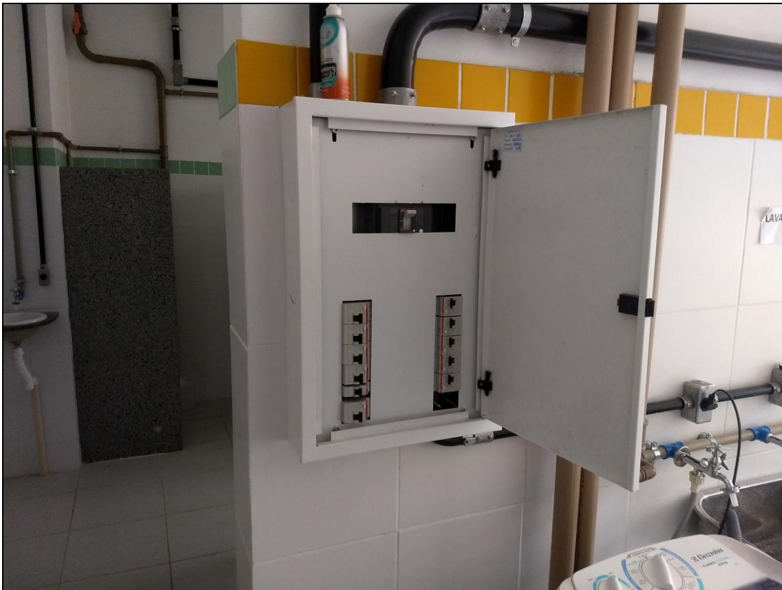
Foto 10 – Caixas centrais de distribuição elétrica instaladas nos banheiros concluídos do 2º e 3º andar
