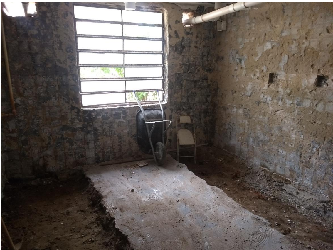
Foto 18 - Execução do corte do contrapiso e da aguada para a instalação dos dutos de esgoto no banheiro do 1º Andar.
