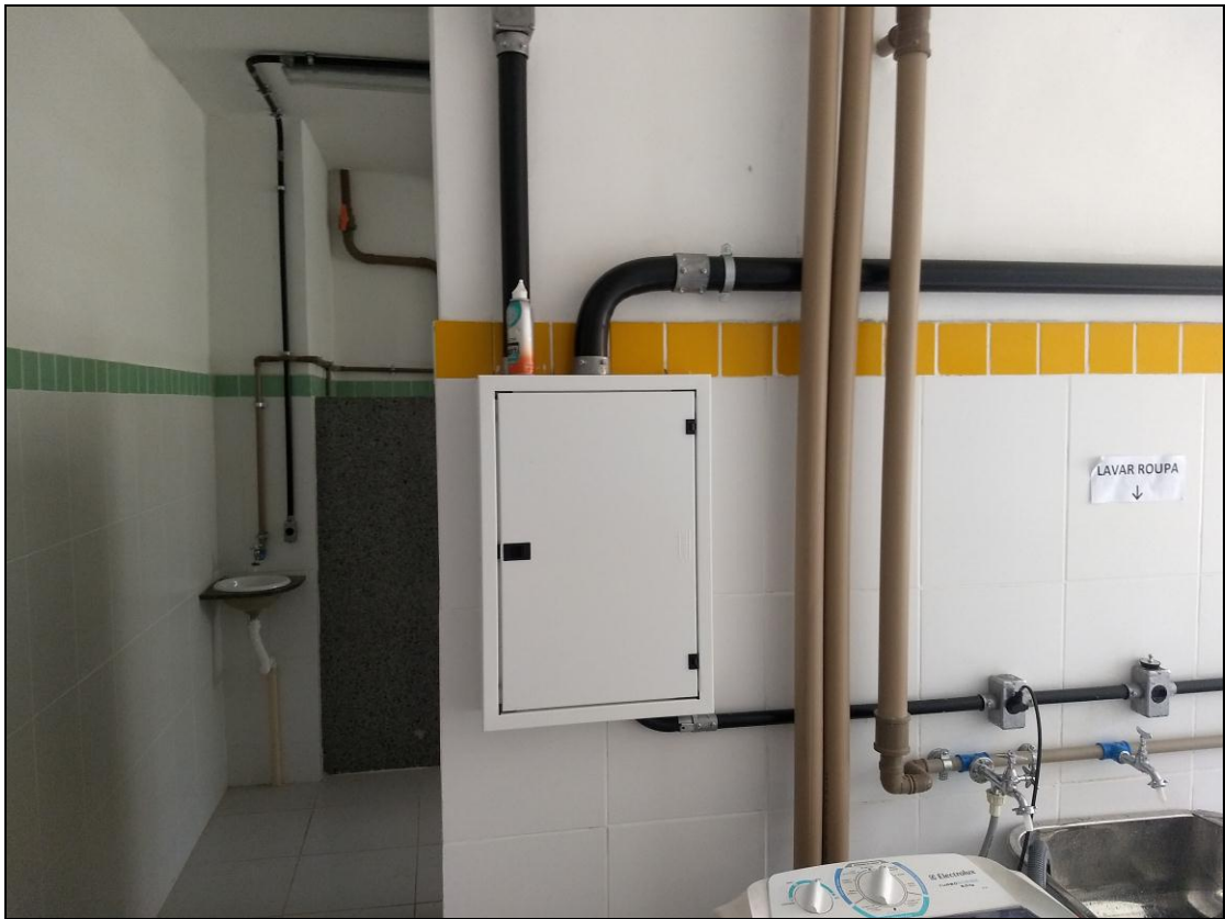
Foto 09 – Caixas centrais de distribuição elétrica instaladas nos banheiros concluídos do 2º e 3º andar
