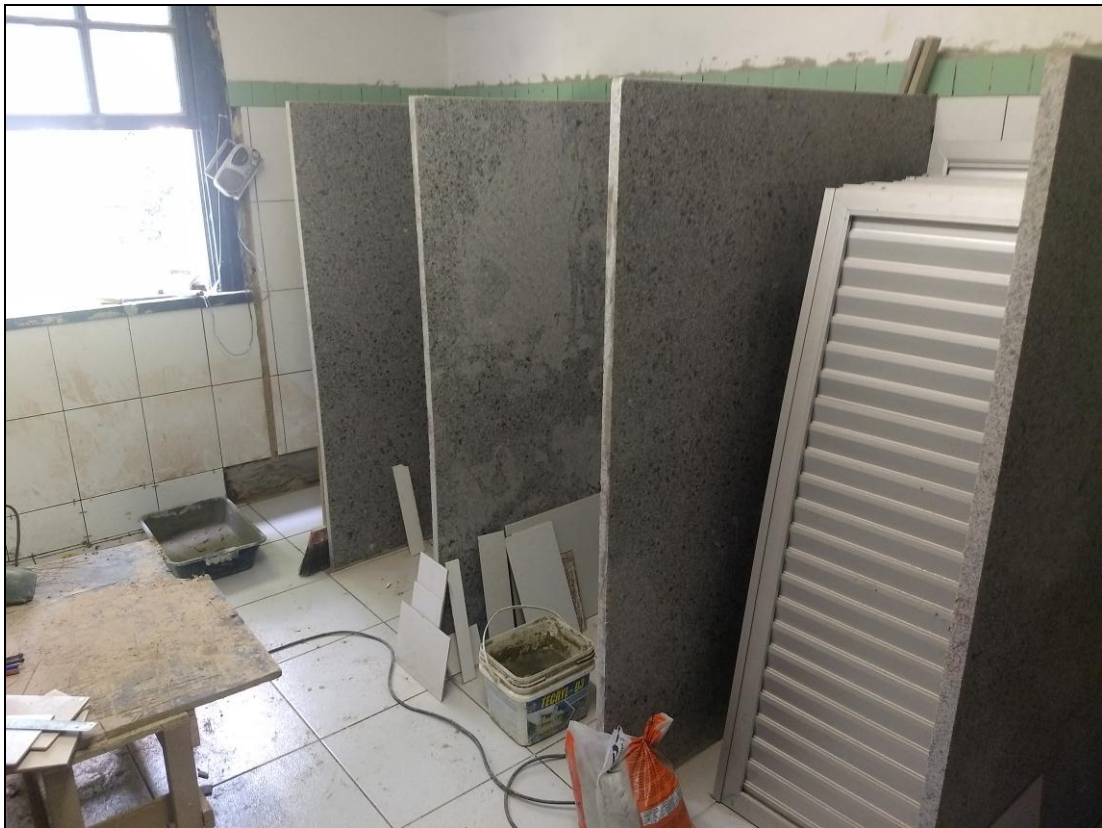
Foto 08 – Finalização da instalação das divisórias de granito do banheiro do 2º andar.
