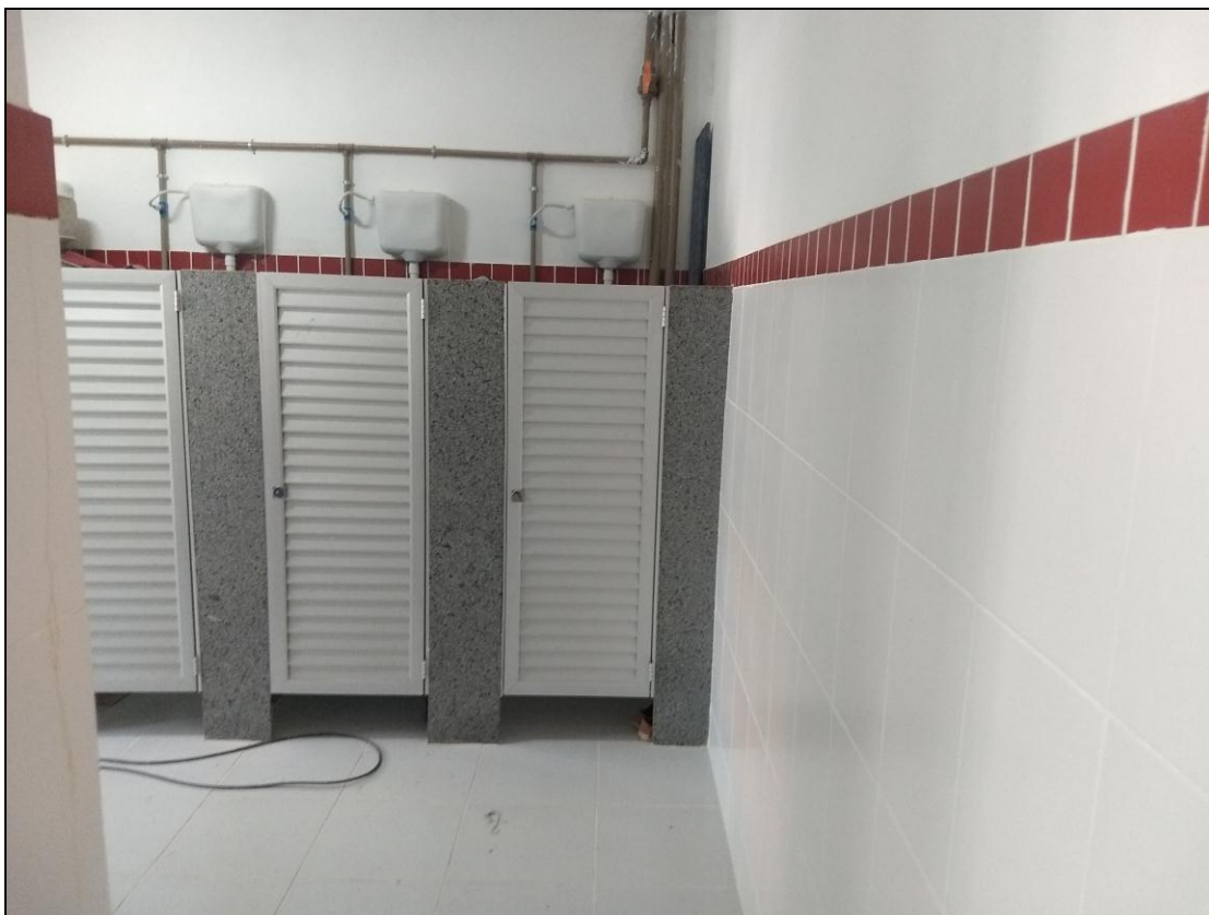
Foto 13 – Visão panorâmica dos serviços realizados até agora no banheiro do 3º Andar
