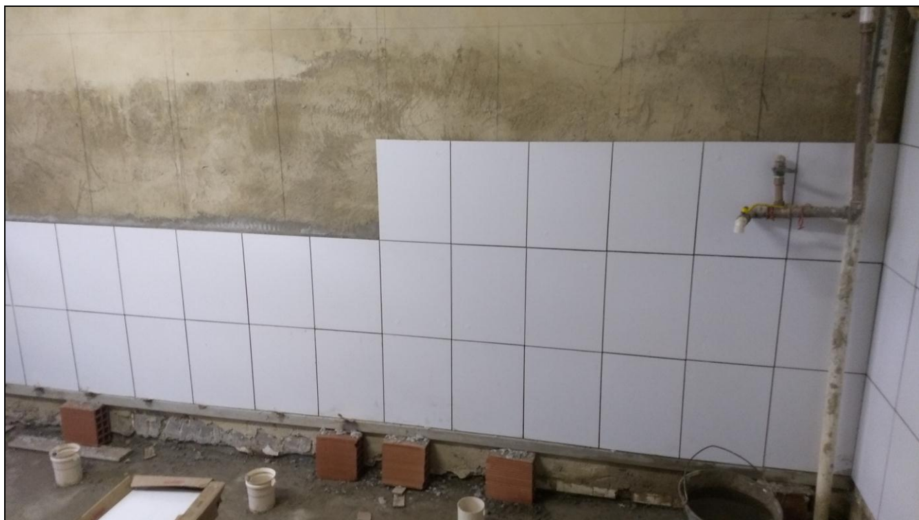
Foto 05 - Início da instalação do revestimento cerâmico das paredes do banheiro do 2º andar
