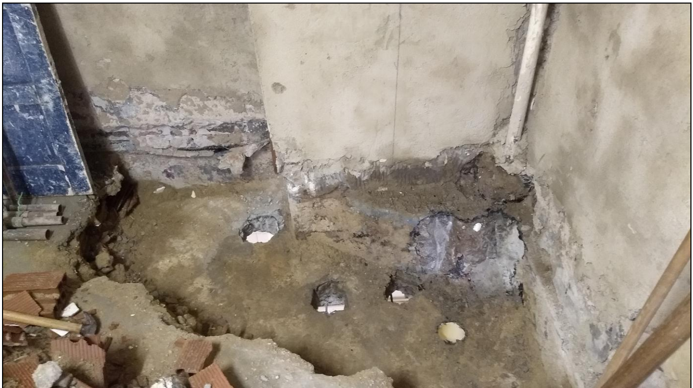
Foto 10 - Preparação para a instalação de coluna de água do banheiro do 2º andar
