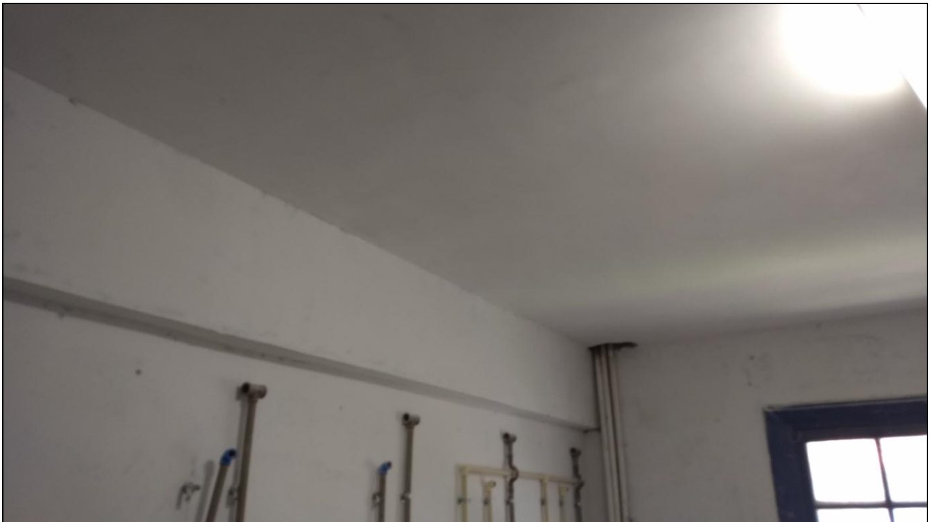
Foto 09 - Conclusão do emboço, aplicação de massa corrida e lixamento do teto do banheiro do 3º andar
