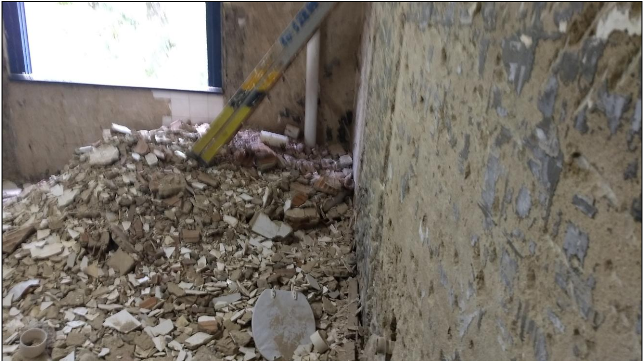
Foto 13 - Início da demolição e retirada dos azulejos das paredes do banheiro do 2º andar
