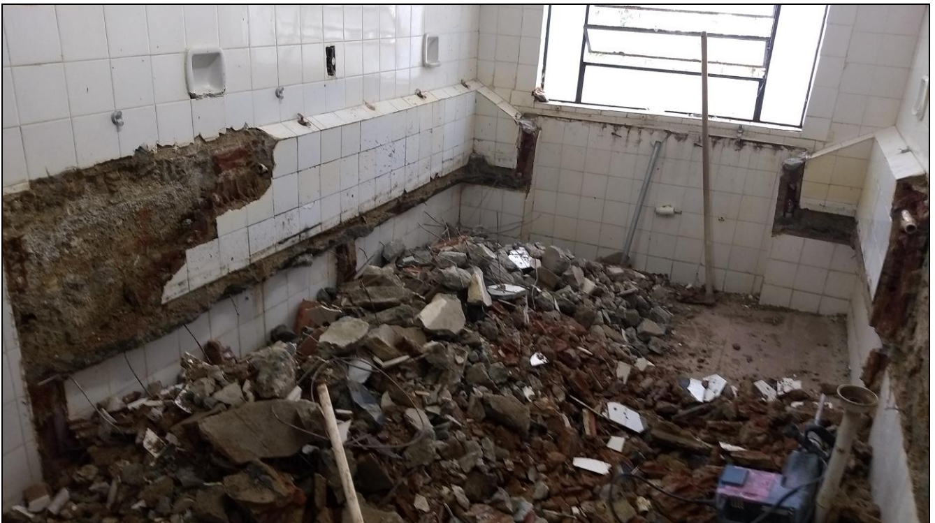
Foto 12 - Início da demolição e retirada dos azulejos das paredes do banheiro do 2º andar
