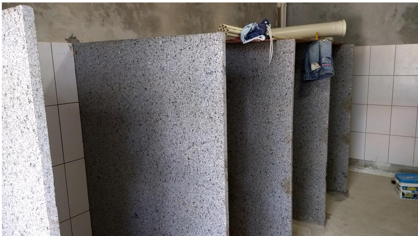
Foto 04 - Instalação de placas de granito das divisórias dos sanitários e chuveiros do banheiro do 3º Andar
