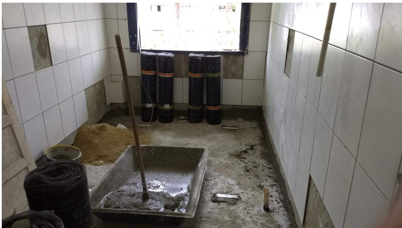
Foto 06 - Concretagem do contra piso do banheiro do 3º Andar, com implantação de manta asfáltica.
