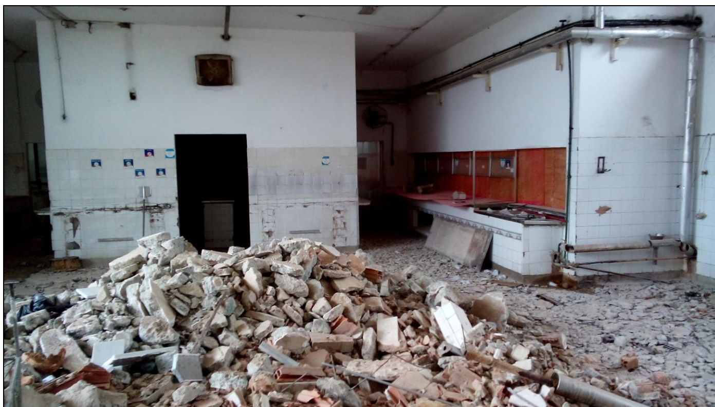
Foto 06: Antiga cozinha do RU após demolição, retirada dos equipamentos e instalação de tapumes para isolamento do canteiro de obras
